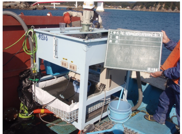
写真 4-3-25 小型排水処理装置 運転状況
