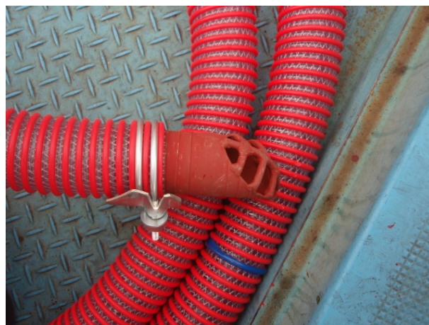
写真 4-3-13 フレキシブルホース 50A 及び吸込み口
