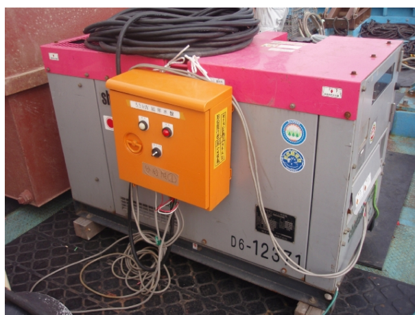
写真 4-3-11 発電機 15KVA 及びポンプ起動盤
