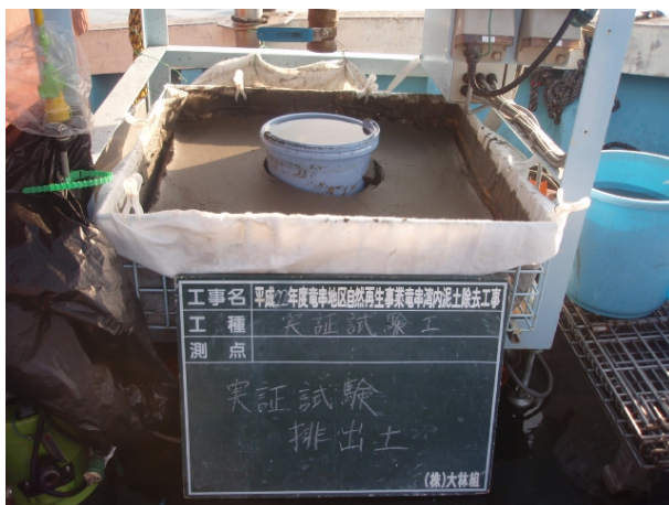
写真 4-3-28 小型排水処理装置 排出土
