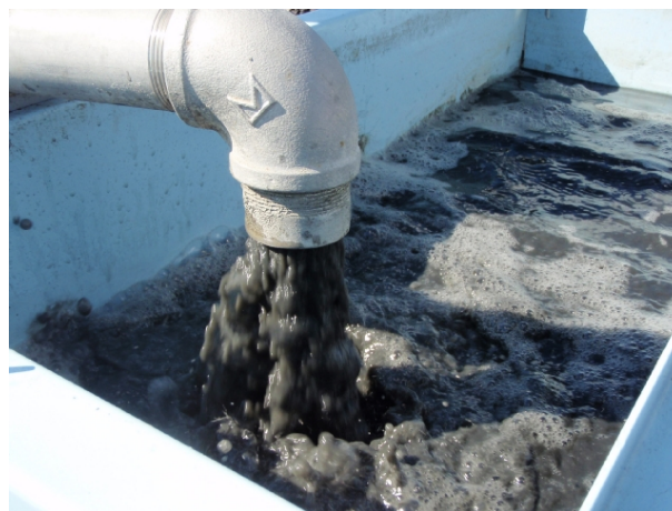
写真 4-3-23 小型排水処理装置 原水流入状況
