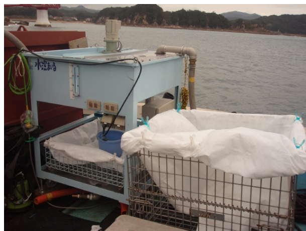
写真 4-3-22 小型排水処理装置及び脱水カゴろ布設置状況
