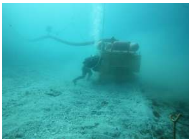
写真 2-6-6 現位置分級器運転状況
