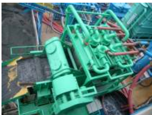
写真 2-13-1 平成 18 年度 振動篩外観
