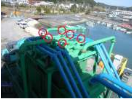
写真 2-13-3 平成 20 年度 振動篩外観
