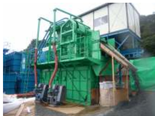
写真 2-13-2 平成 19、20 年度 振動篩外観
