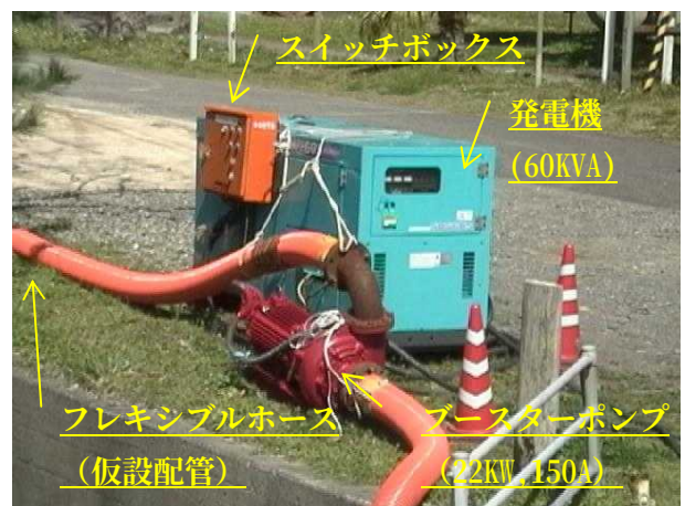
写真 2-5-29 発電機(ブースターポンプ用) (60KVA)
