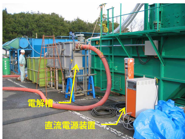
写真 3-7-6 電解槽と直流電源
