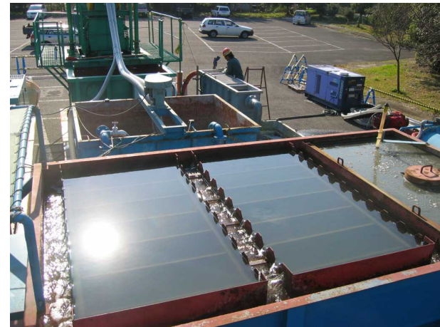
写真 3-6-21 シックナー処理状況
