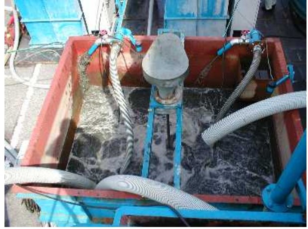
写真 3-6-19 原水槽運転状況
