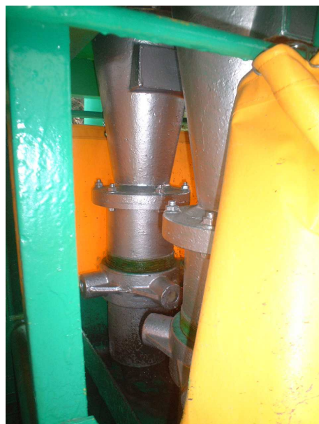
写真 3-6-13 サイクロン部
