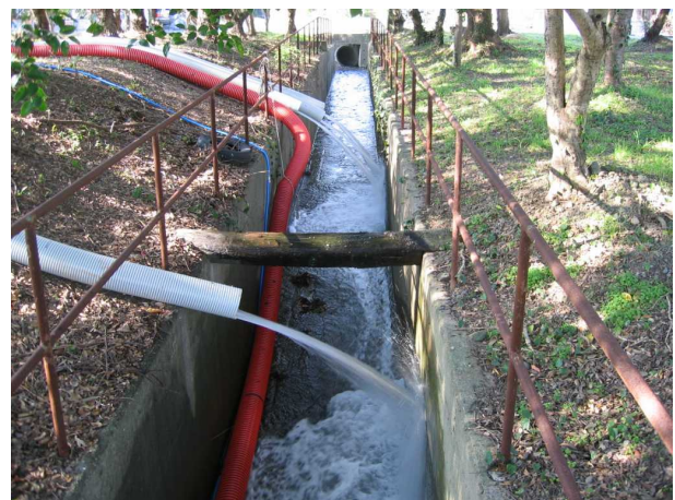
写真 3-6-23 処理水排水状況
