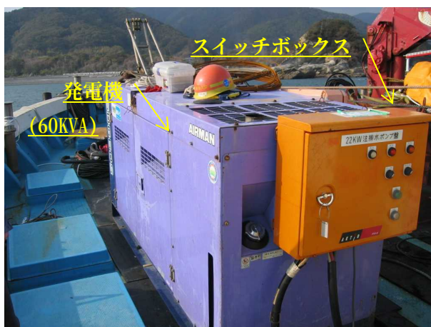
写真 2-5-28 発電機 (船上) (60KVA)
