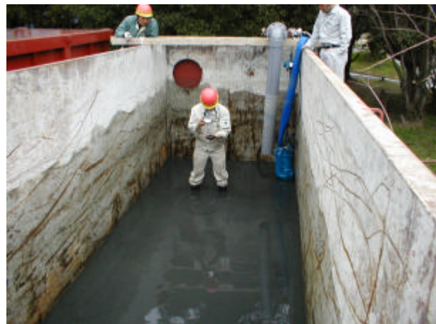
写真 3-8-14 排水ポンプ設置状況
