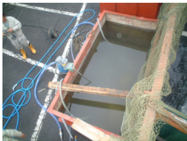
写真 3-5-16 高分子凝集剤溶解槽
