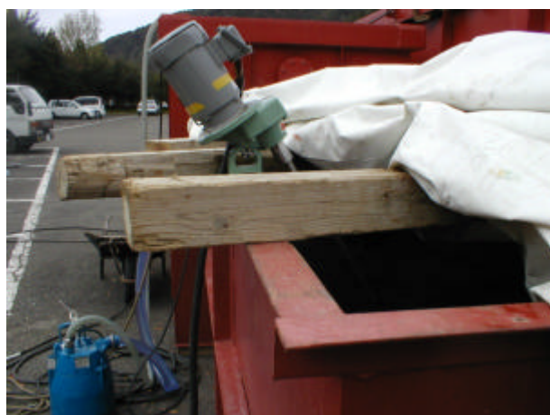
写真 3-5-15 凝集剤溶解槽・攪拌機
