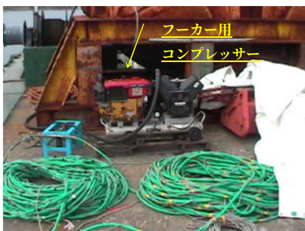
写真 2-3-21 フーカー用コンプレッサー
