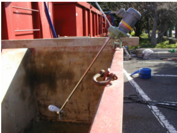
写真 3-8-13 凝集剤溶解槽・攪拌機設置状況
