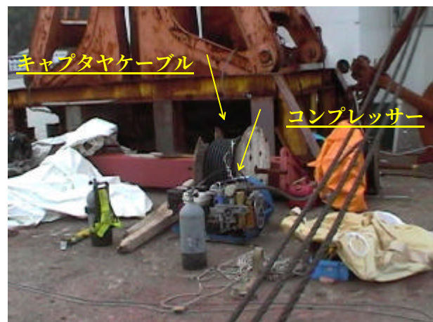
写真 2-3-20 予備タンク用コンプレッサー キャプタイヤケーブル
